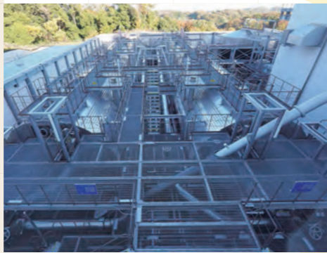
9/ 燃やせるごみの中から選別された有機性のごみは、微生物の働きで発酵させ、バイオガスを発生させます。
